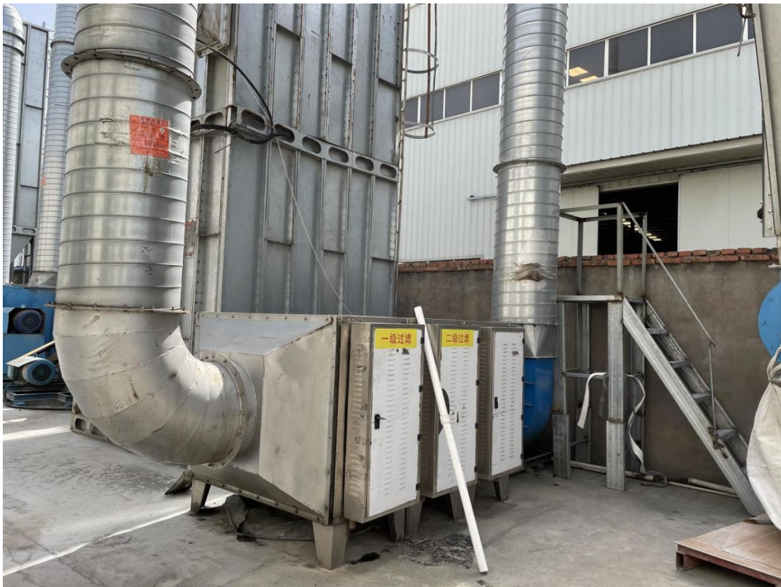
图 7-2 活性炭处理设施
