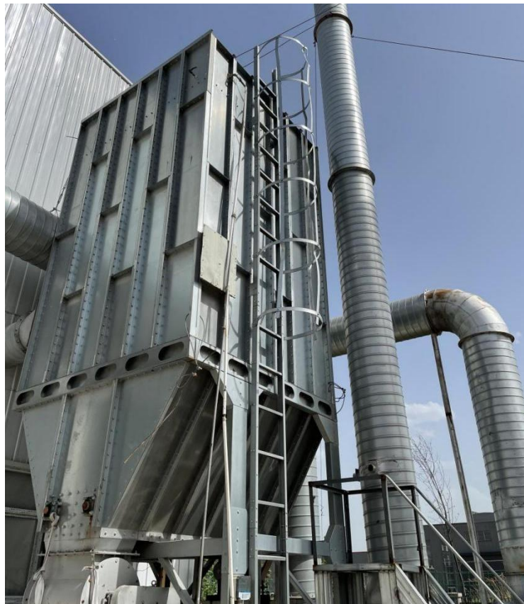
图 7-4 布袋除尘器+排气筒
