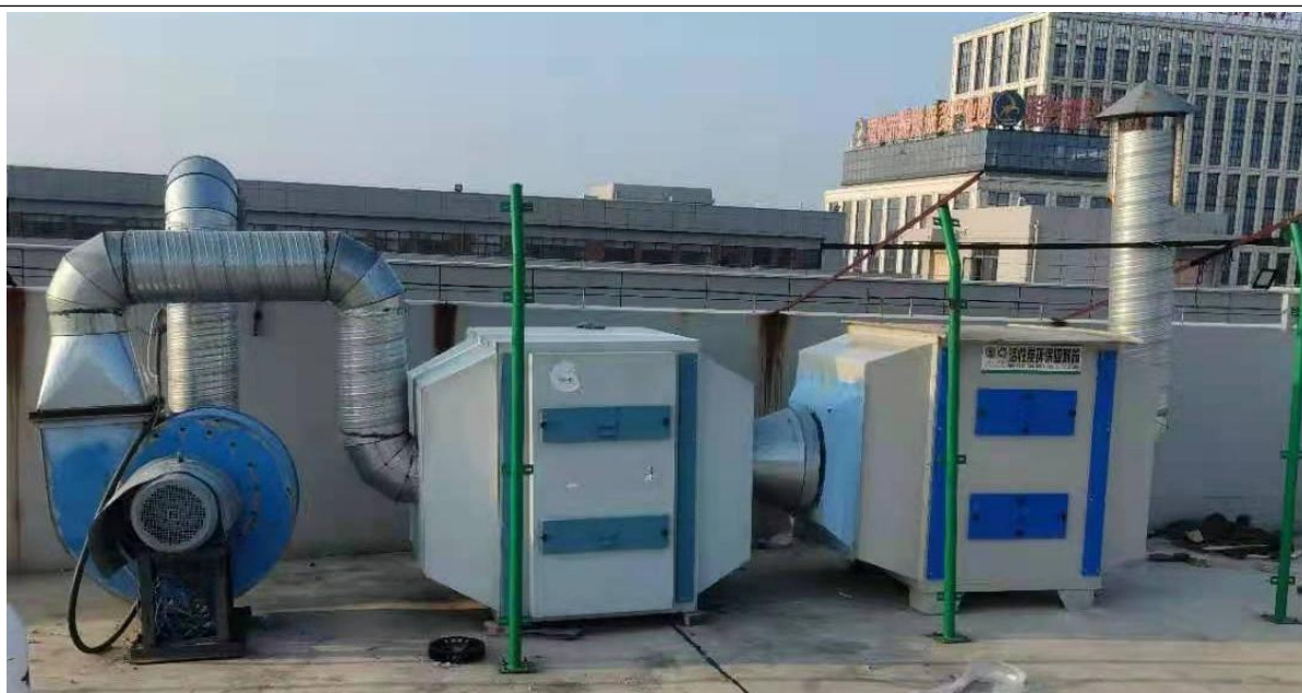
废气处理设施
