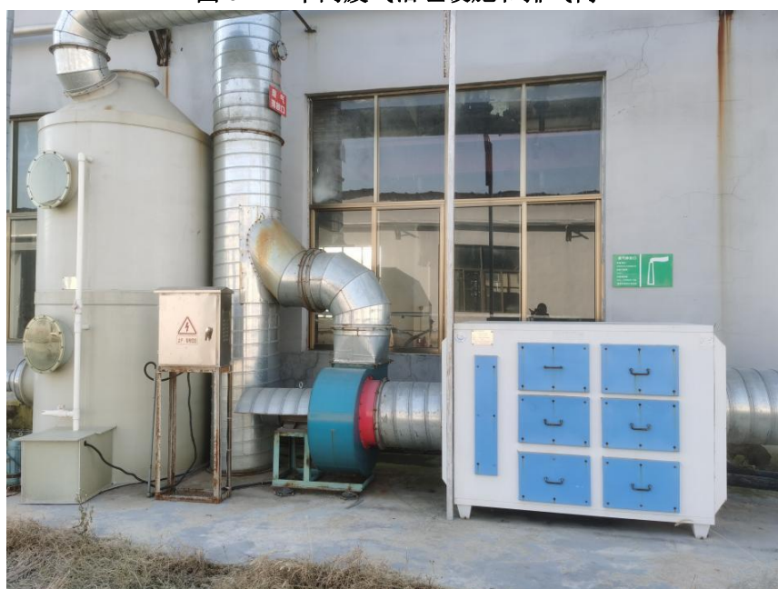
图 6-3 3#车间废气治理设施和排气筒
