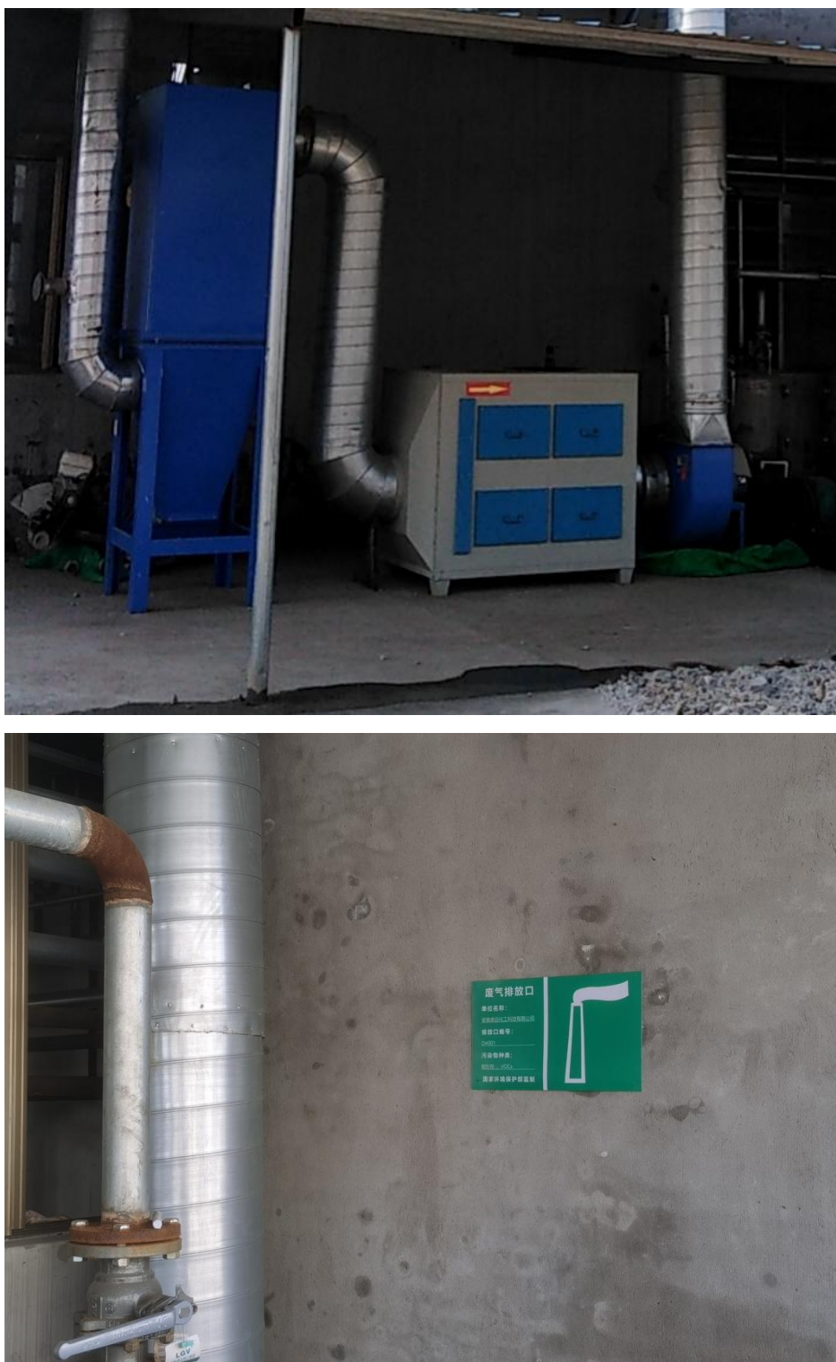
图 6-1 1#车间废气治理设施和排放口
