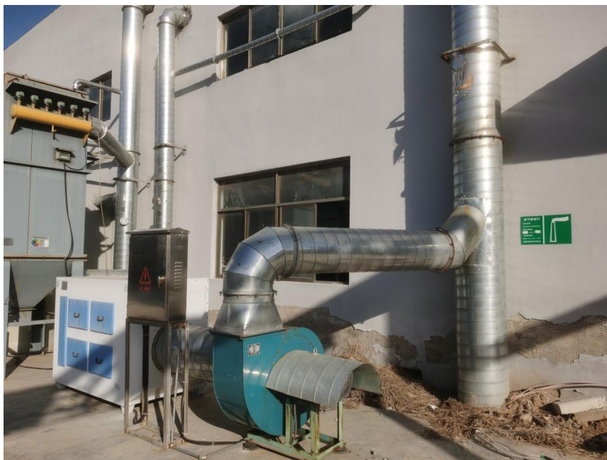
图 6-2 2#车间废气治理设施和排气筒
