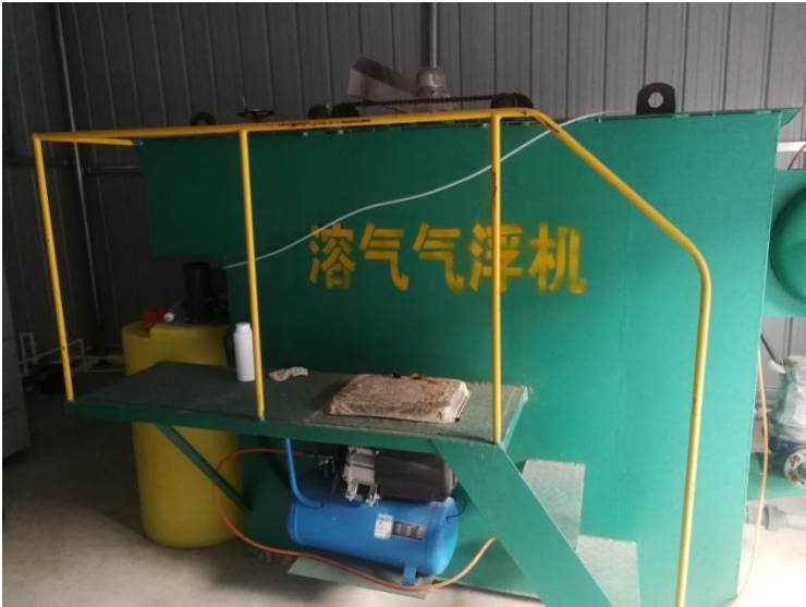
图 6-4 污水处理设施
