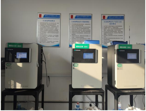
图 8-2 污水站进口在线监测
