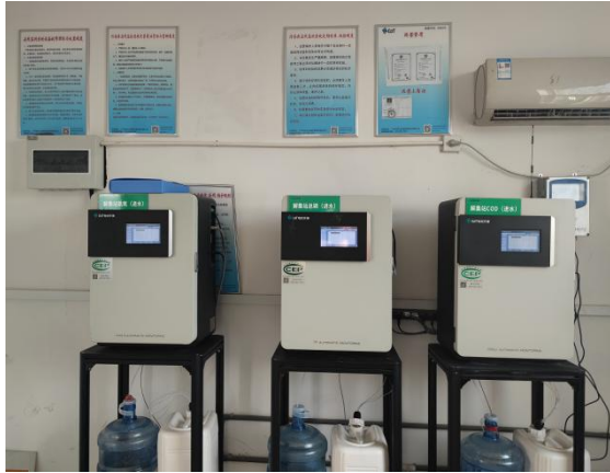
图 8-1 污水站进口在线监测
