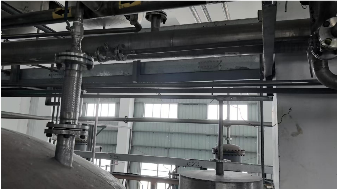
图 4.1-11 车间废气收集管道
