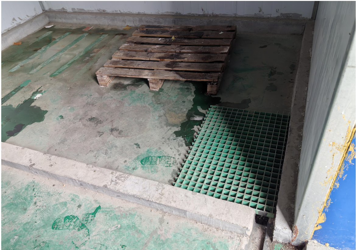
图 4.1-16 危废库地面防渗及集液坑
