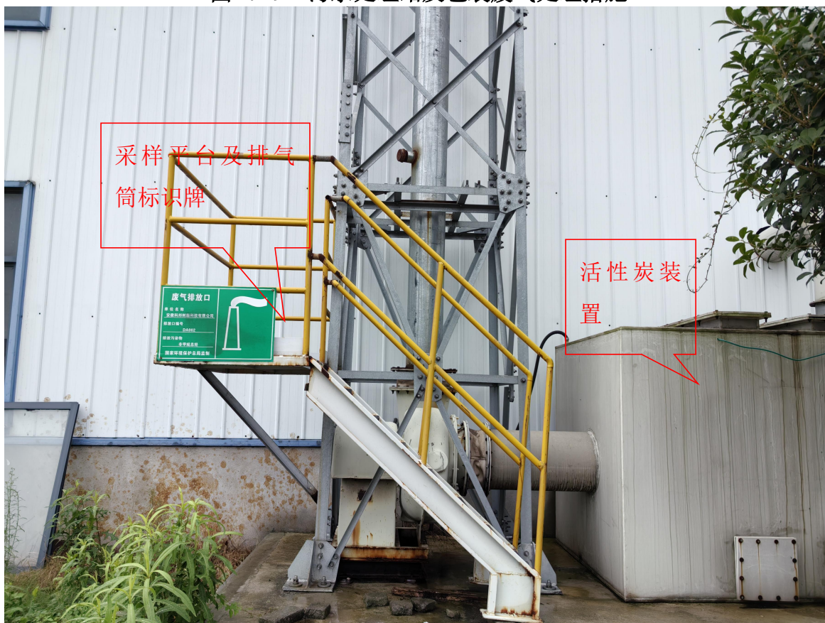
图 4.1-10 危废库废气处理装置
