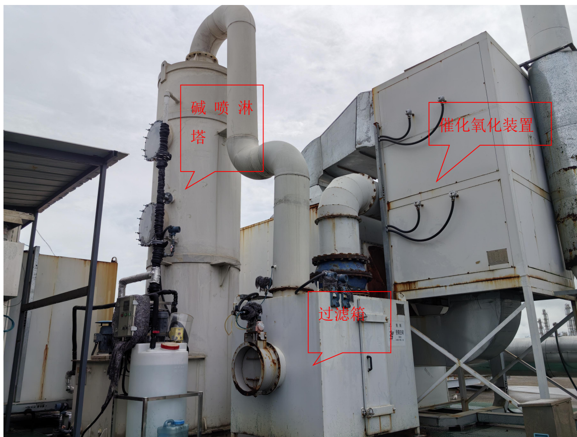
图 4.1-7 罐区及车间废气处理措施
