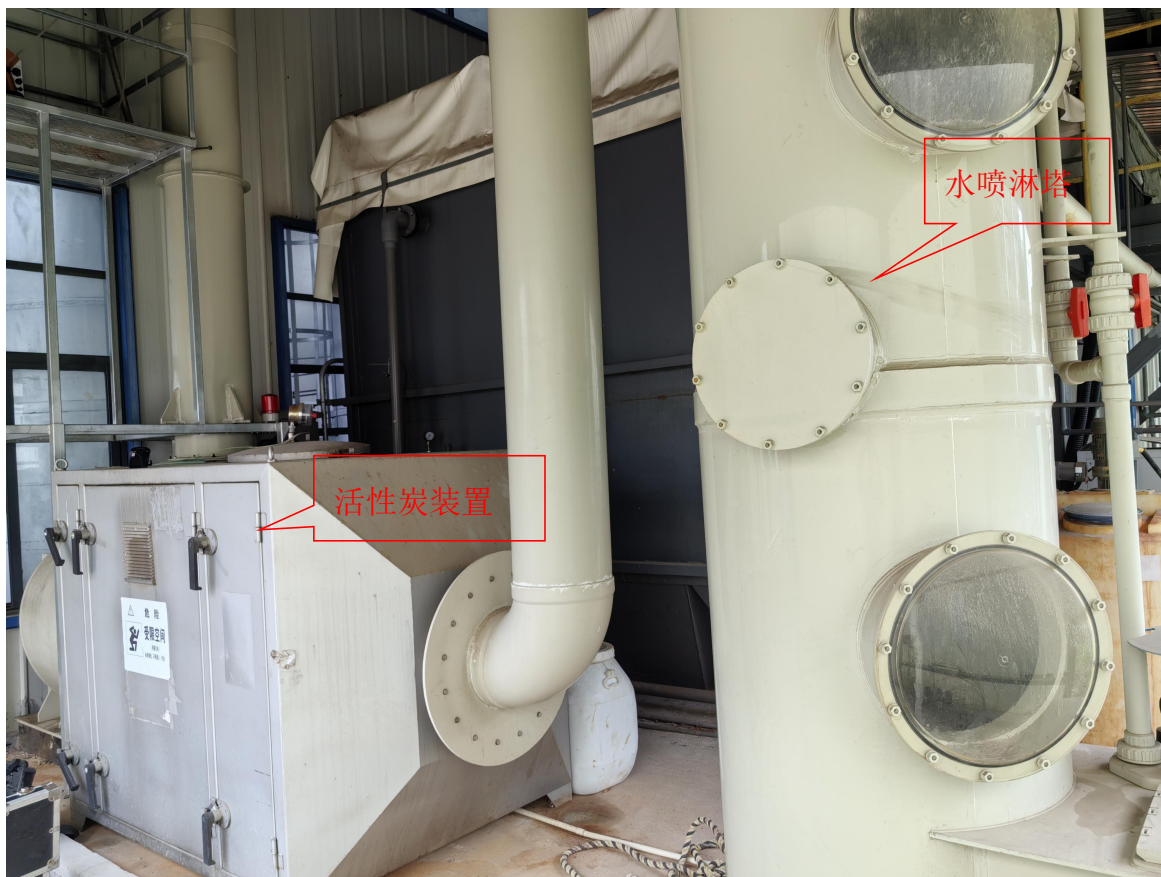
图 4.1-9 污水处理站及包装废气处理措施
