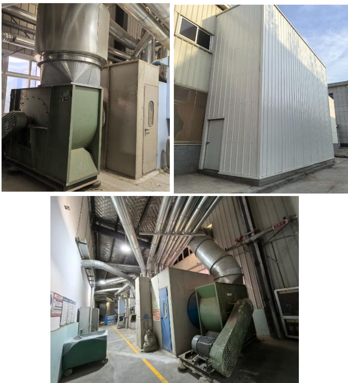
图 3-1 复合圆筒除尘机组（两级滤尘设施）和排风井
