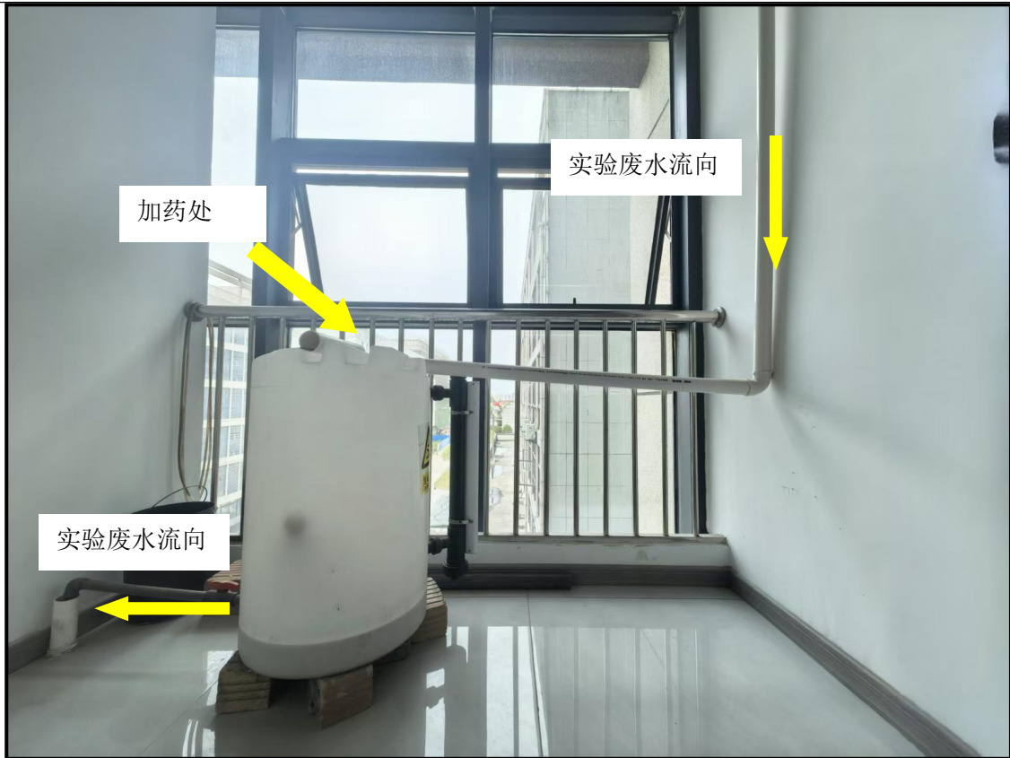
图 3-4 废水排放口和 pH 调节设施
