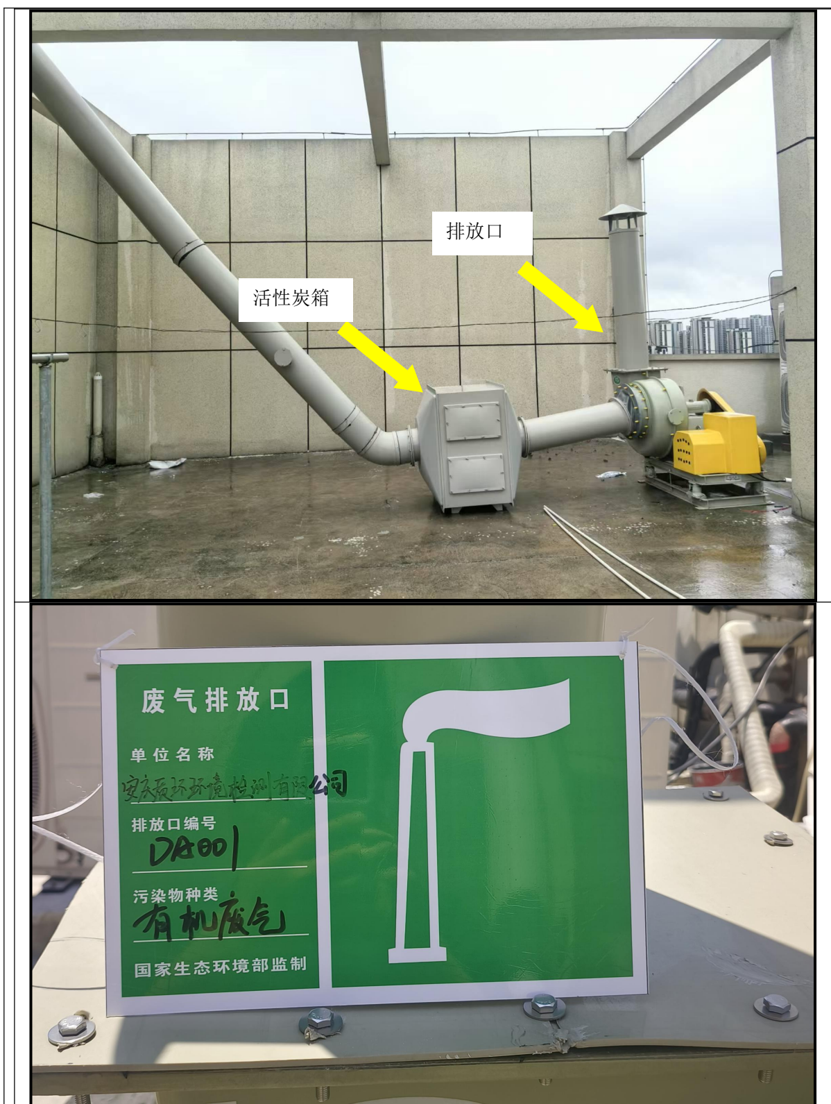
图 3-2 废气收集和治理设施
