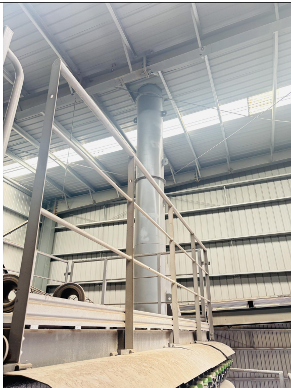
再生料筛分废气排气筒
