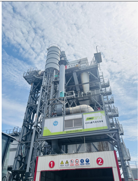
沥青烟气治理设施
